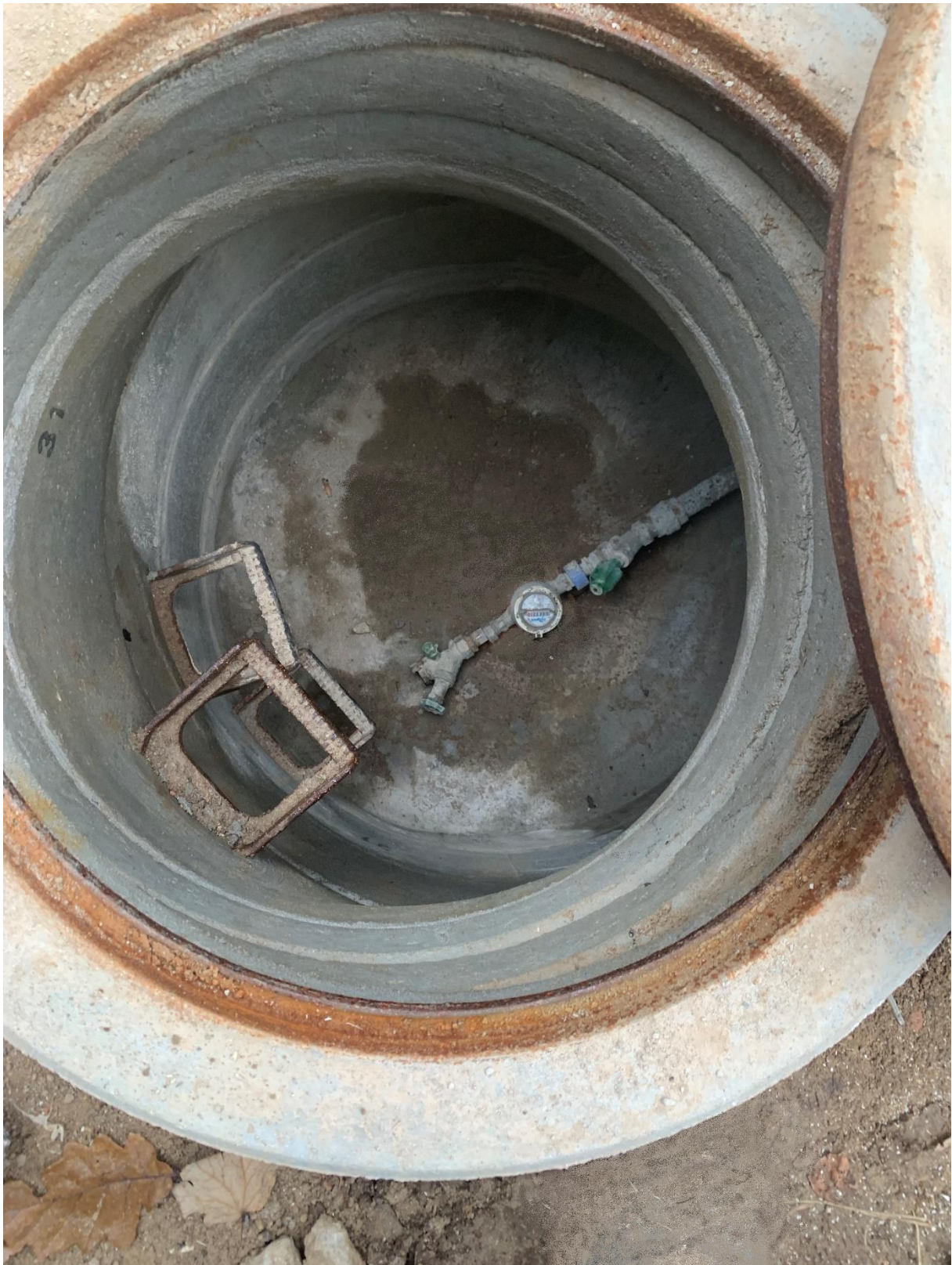
Beispiel eines Bauwasseranschlusses auf vorhandener alter Hausanschlussleitung
